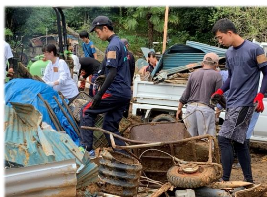
ボランティアによる土砂に埋もれた家財道具等の撤去作業の様子(多久市)
